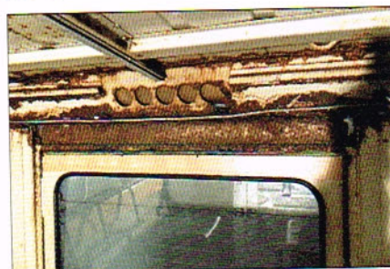
Tot in de dakrand is herstel nodig. Vaak zijn dat lastige hoekjes
