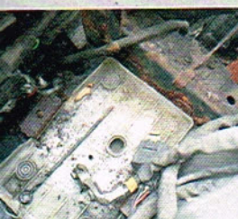
9 Typische Stelle: Je nach r rostet es vorne links oder s unterhalb der Batterie
